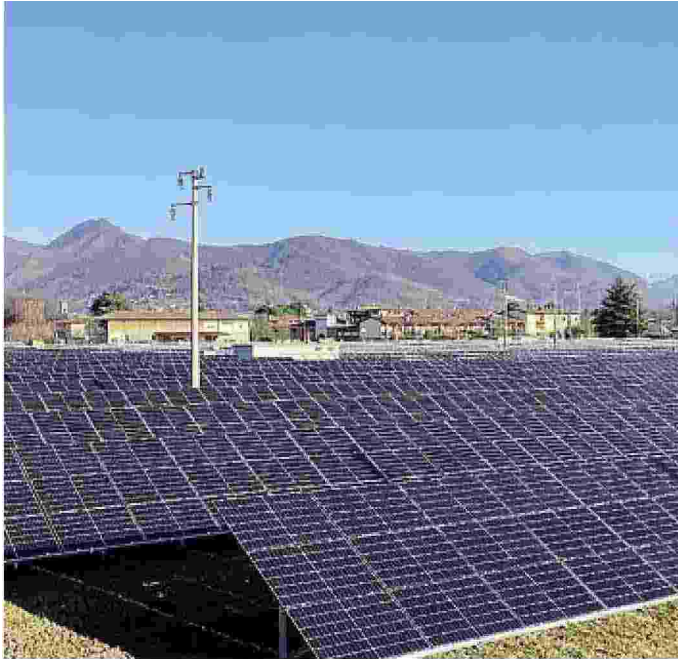
Pronta a entrare in funzione a Torre Boldone la Cer Imotorre
